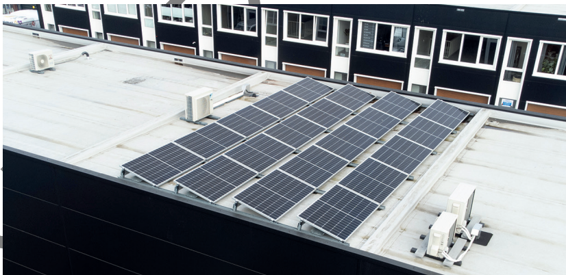
PV-panelen op bedrijfspand
